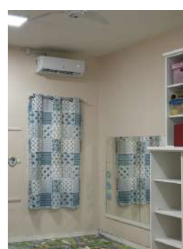
Climatização de sala de atendimento
